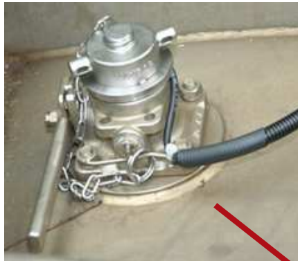
Sensor in der Belüftungsöffnung
